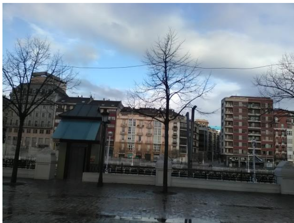
Areatzako elektrizitate kableek osatutako katenaria
